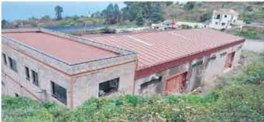
LAS HUMEDADES PRUEBAN EL PASO DEL TIEMPO SIN UN MÍNIMO DE MANTENIMIENTO. A. P.
